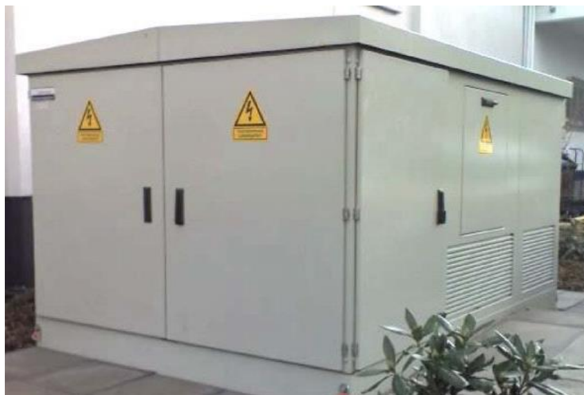
شکل شماره ۱۹-پست کمپکت پیش ساخته
