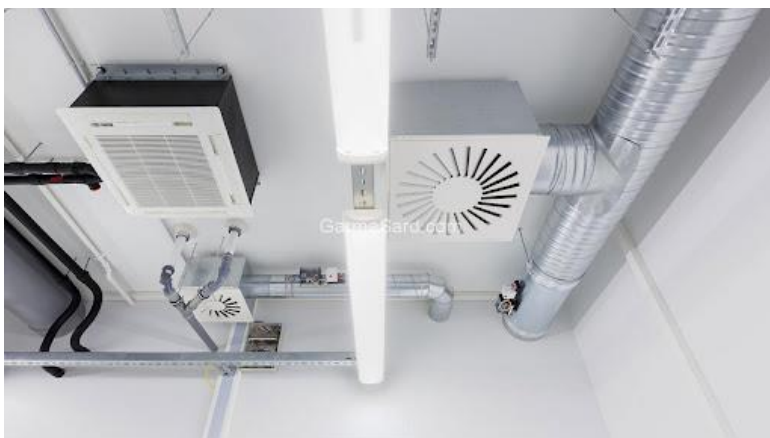
شکل شماره ۱۳- کانال فرعی HVAC برای گردش هوا در محل نصب تابلو
